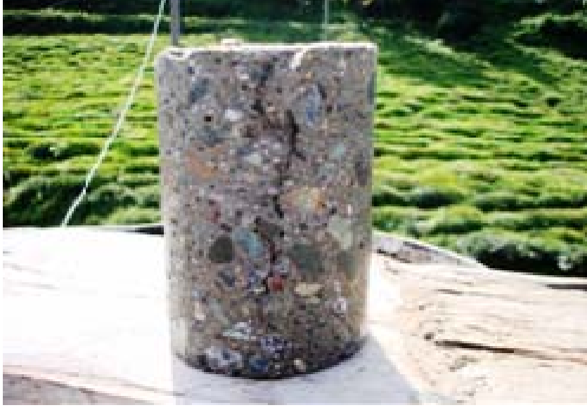
Şekil 3. Şekil 1 ve Şekil 2'deki döşeme betonundan alınan karot görüntüsü
