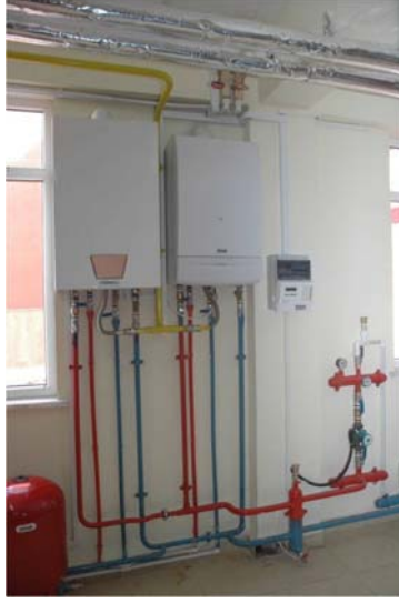
Şekil 3. Ferroli Isıtma Laboratuvarı Isıtma Tesisatı Ekipmanları ve Cihazları
