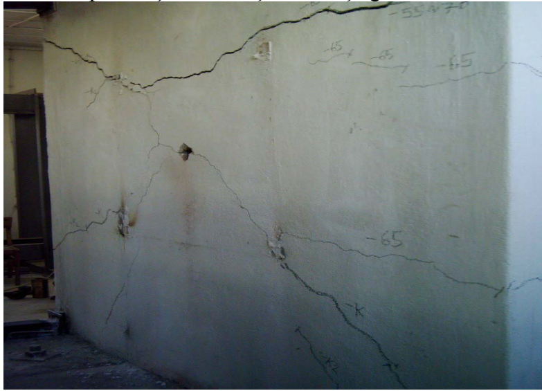
Şekil 3. Referans Duvarın Çatlak Deseni
