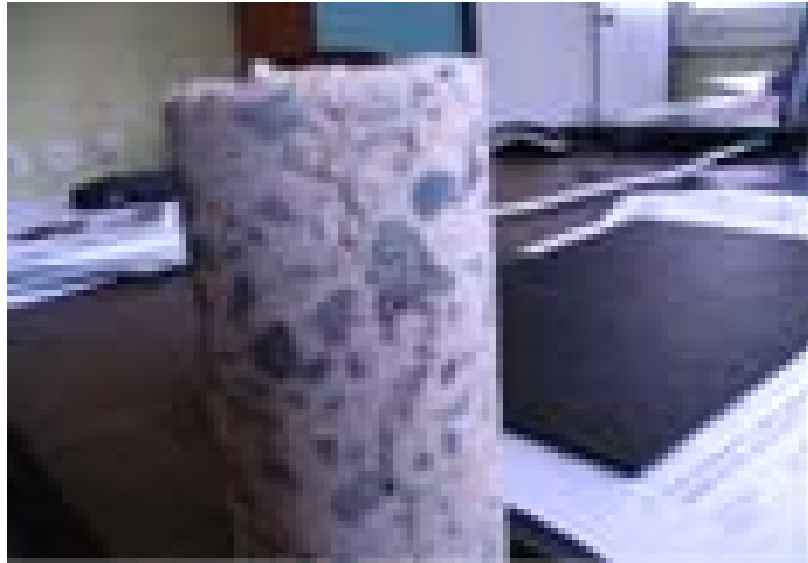
Şekil 11. Rize ili Çayeli ilçesi özel bina döşeme betonu karotu görüntüsü
