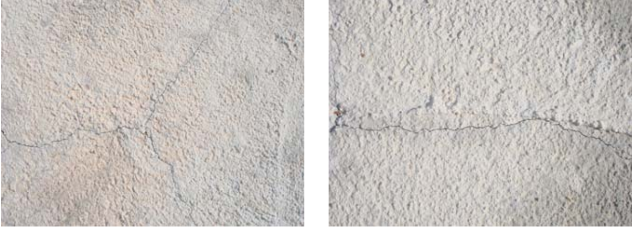
Şekil 1. Döşeme betonunda çatlak görüntüsü
