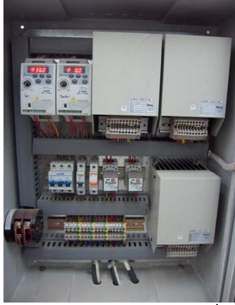
Şekil 10. Kumanda ve Kontrol Panosunun İç Görünümü
