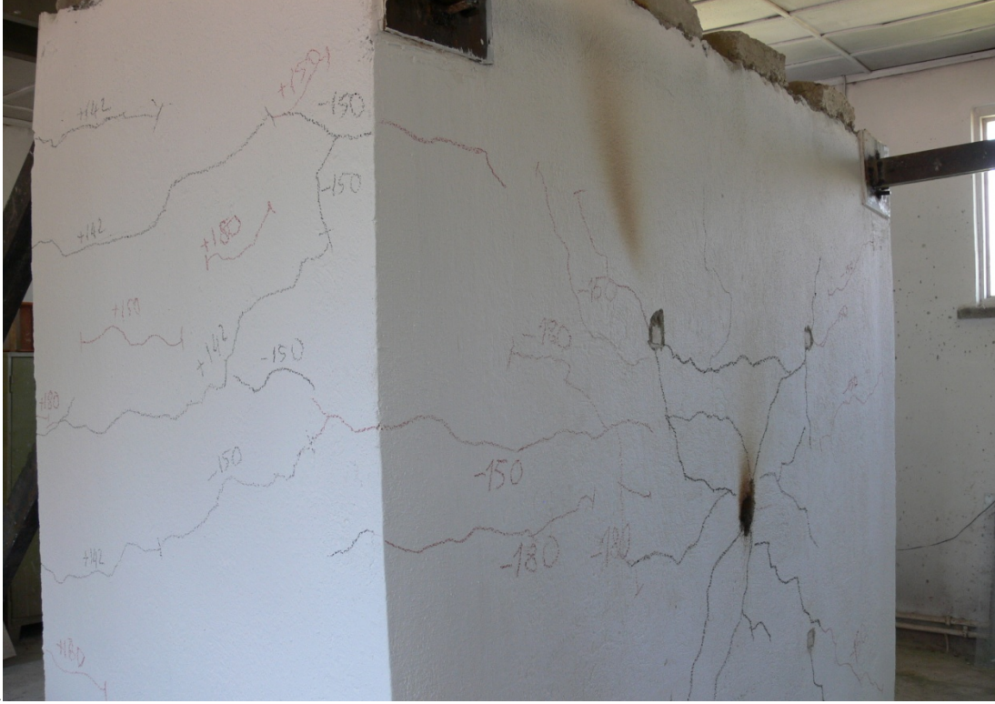
Şekil 4. Güçlendirilmiş Duvarın Çatlak Deseni (Kalkan 2008)
