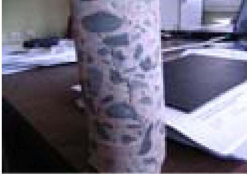
Şekil 10. Rize ili Çayeli ilçesi özel bina döşeme betonu karotu görüntüsü
