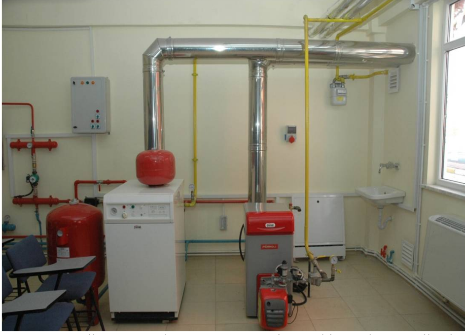
Şekil 2. Ferroli Isıtma Laboratuvarı Gaz Tesisatı Ekipmanları ve Cihazları
