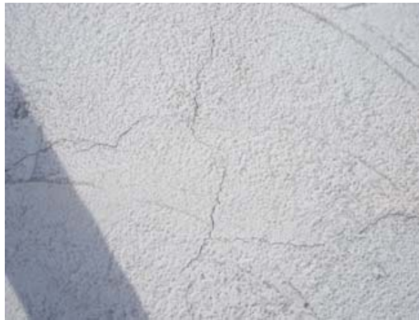
Şekil 2. Harç macunu uygulandıktan sonra yine çatlakların gelişmesi
